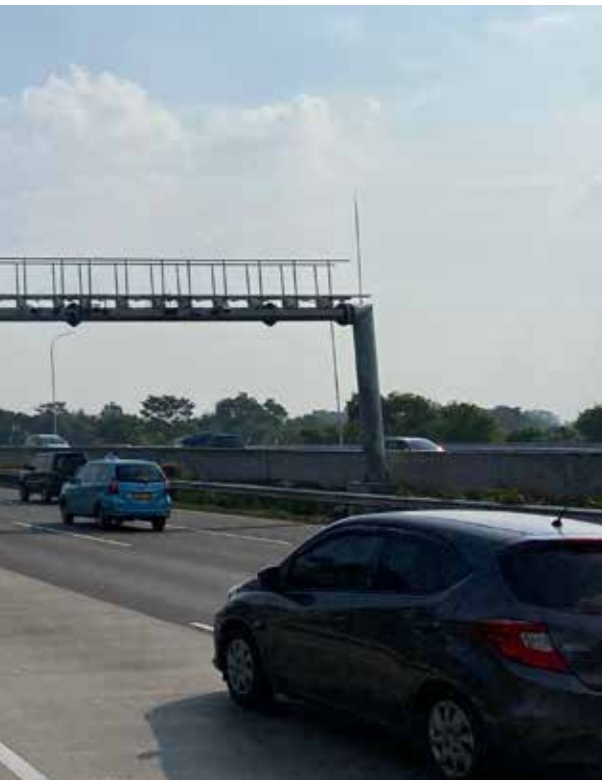
Pemasangan gantry sistem transaksi multi lane free flow (MLFF) di Jalan Tol Jagorawi
