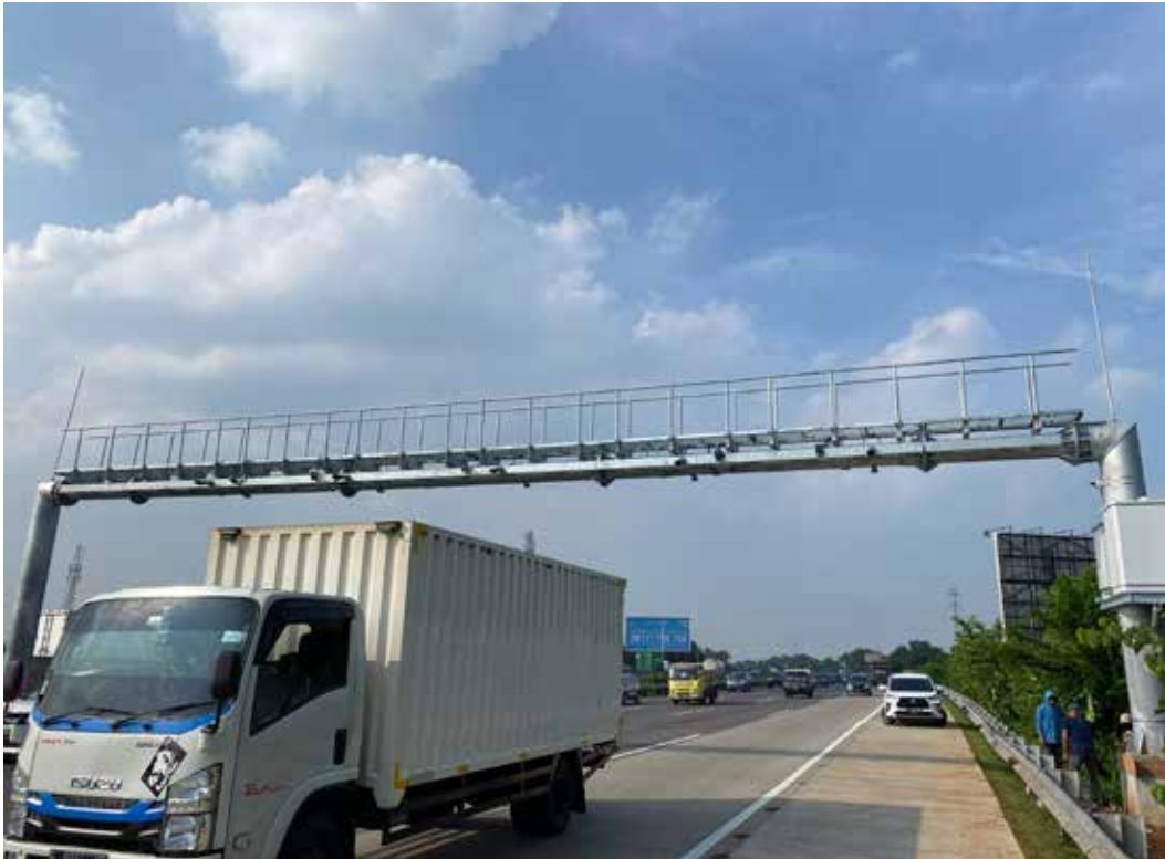
Gantry di jalan tol untuk transaksi di jalan tol dengan multi lane free flow (MLFF).
