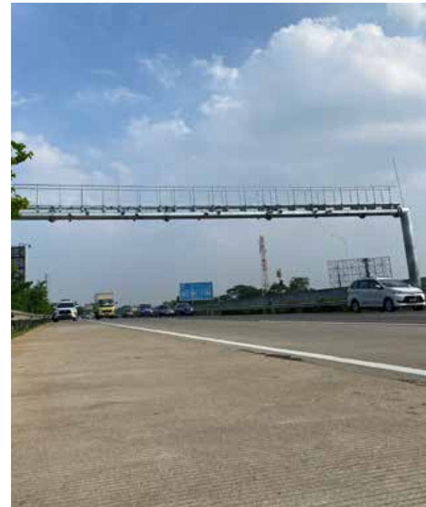
Pemasangan gantry sistem transaksi multi lane free flow (MLFF) di Jalan Tol Jagorawi
