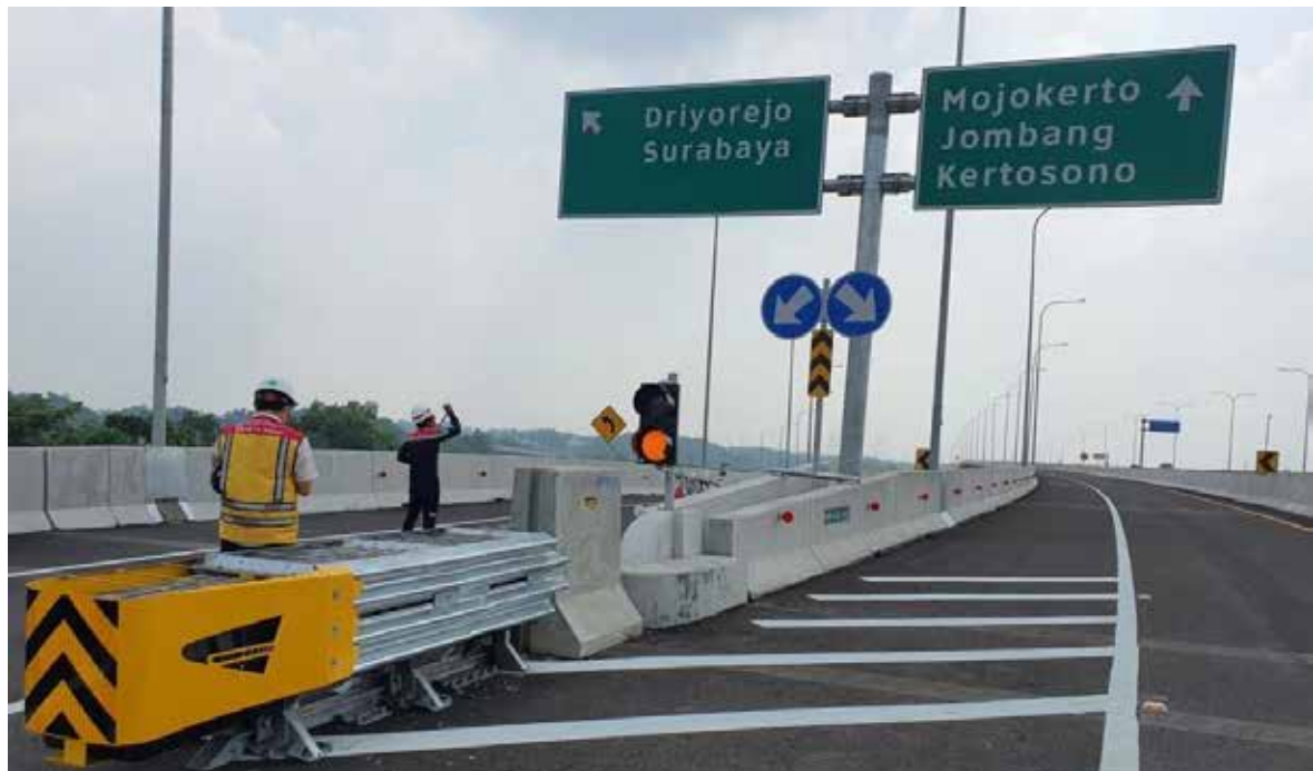
Penerapan crash cushion pada daerah diverging di Junction Wringinanom Jalan Tol Krian-Legundi-Bunder-Manyar.
